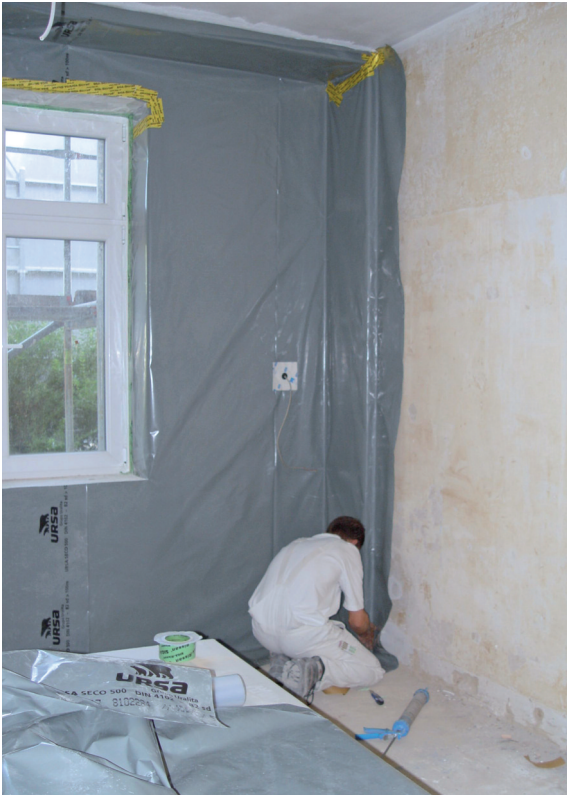
7 Dampfbremsen müssen lückenlos über die Dämmkeile an einbindenden Innenwänden und Decken, sowie an Leibungen verlaufen.
